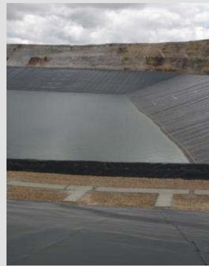
Reservorio de agua "San José"
